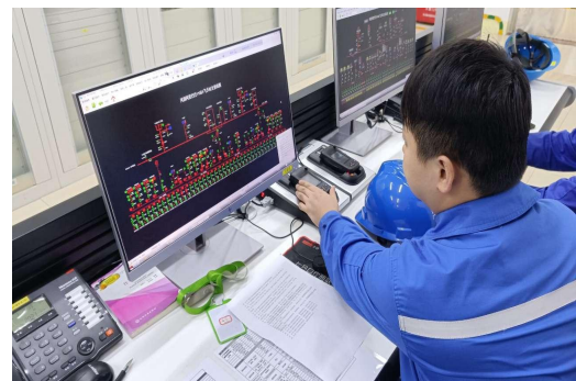
图 5.2-2 14:25:00 值班人员进行#1 主变由运行状态转检修状态倒闸操作
