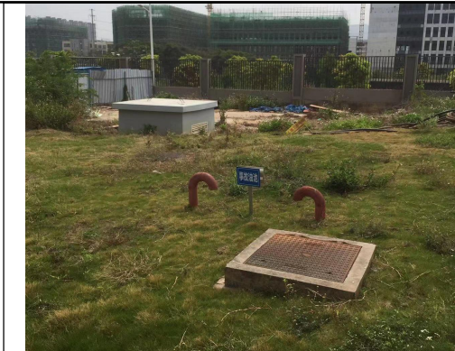
图 3.3-1 站内现有事故油池
