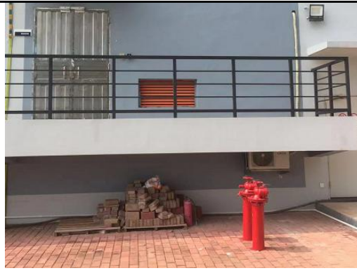
图 3.3-2 站内现有消防设备
