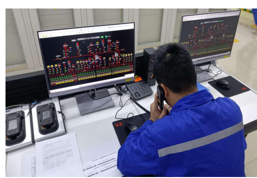
图 5.2-1 14:15:00 演练现场总指挥下令：启动《变压器油泄漏应急预案》，向河源地调申请将#1 主变由运行状态转为检修状态
