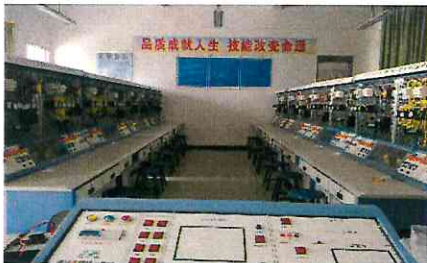
电子电工实训室
